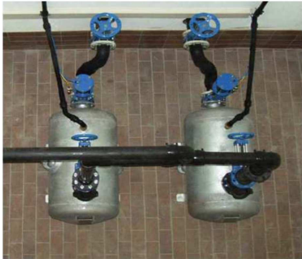
Arbeitsbehälter mit Armaturen und Rohrleitungen
